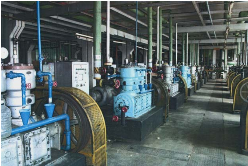
A hűtőház kompresszorcsarnoka
